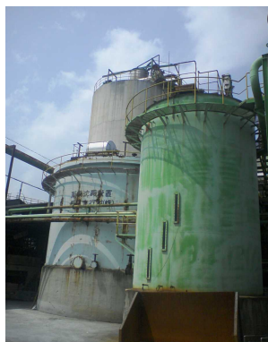
②凝集ろ過装置
