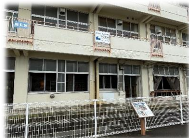
荒浜小学校 津波浸水高の跡
